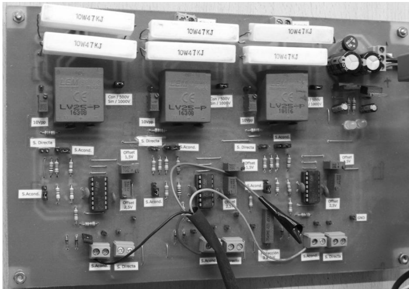
Figura A-9: Fotografía del circuito de medición de tensión.
