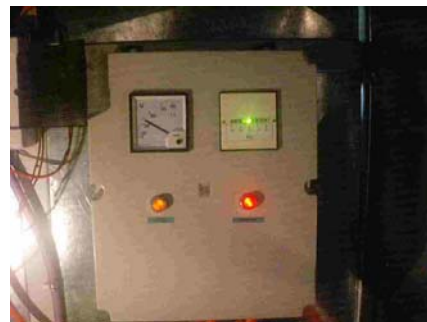
Fig. 8 Aspecto exterior de regulador
