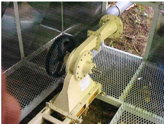
Detalle de la turbina instalada
