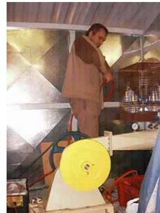
Vista lateral del conjunto turbina-generator
