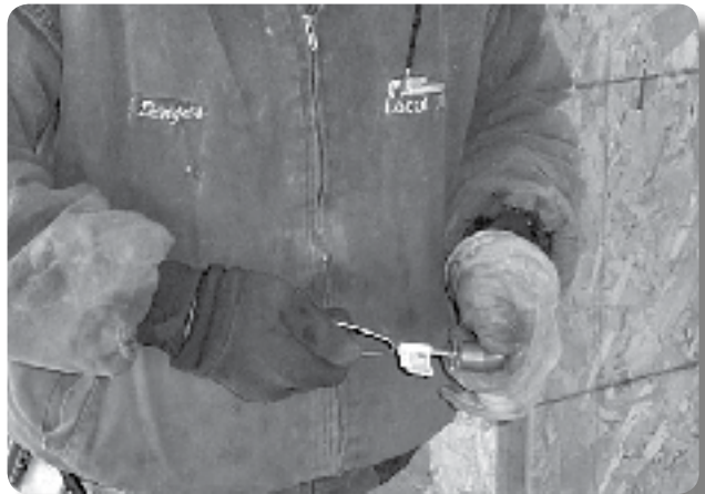
Problema: Cepillado manual de tubos de cobre
