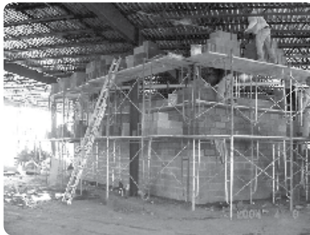
Problema: Andamio convencional sin estructura de protección
