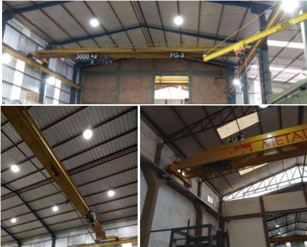
Figura 26: Puentes Grúa 1-2 y 3. Fuente: elaboración propia
