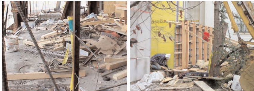
Figura 42 - Falta de orden y limpieza.
