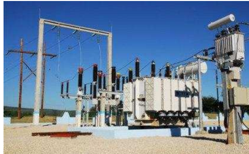
Estación de transformación
