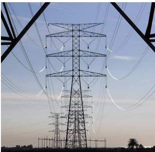
Líneas de alta tensión
