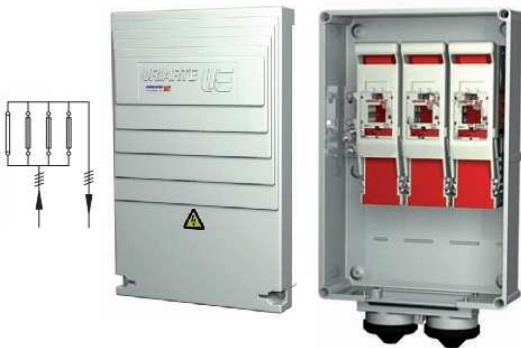
Vista interior de la CGP (fusibles)
