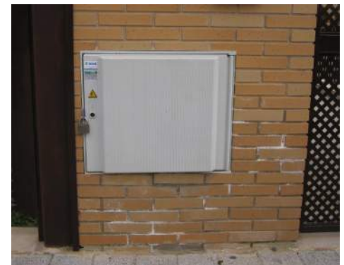
CGP en fachada de un edificio
