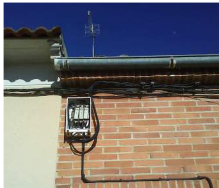
Acometida aérea en fachada y CGP
