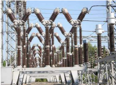
Subestación de transformación
