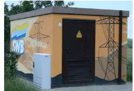
Centro de transformación
