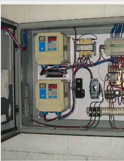
Los variadores de velocidad se suelen instalar en un cuadro independiente junto a los motores que controlan.
