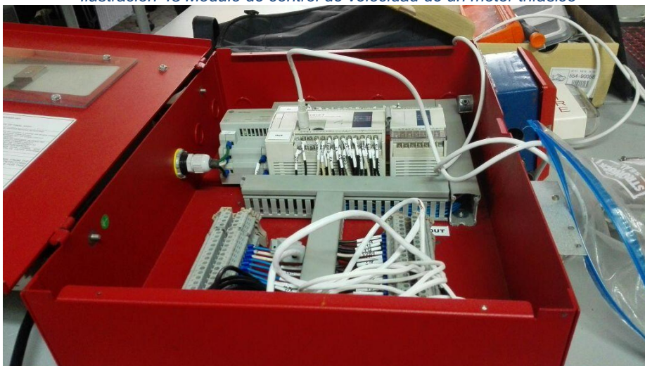
Ilustración 44 PLC con el que se envía señal análoga al variador
